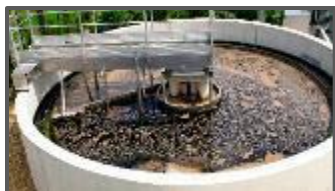
Boues de station épuration
